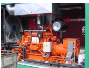
Grupo cabinado insonorizado de la planta de piloto de biomasa Enamora
