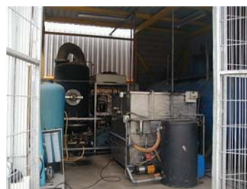
Instalación depuradora aguas industriales
