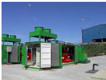
Vista de los equipos de la planta de biomasa de Biocerceda
