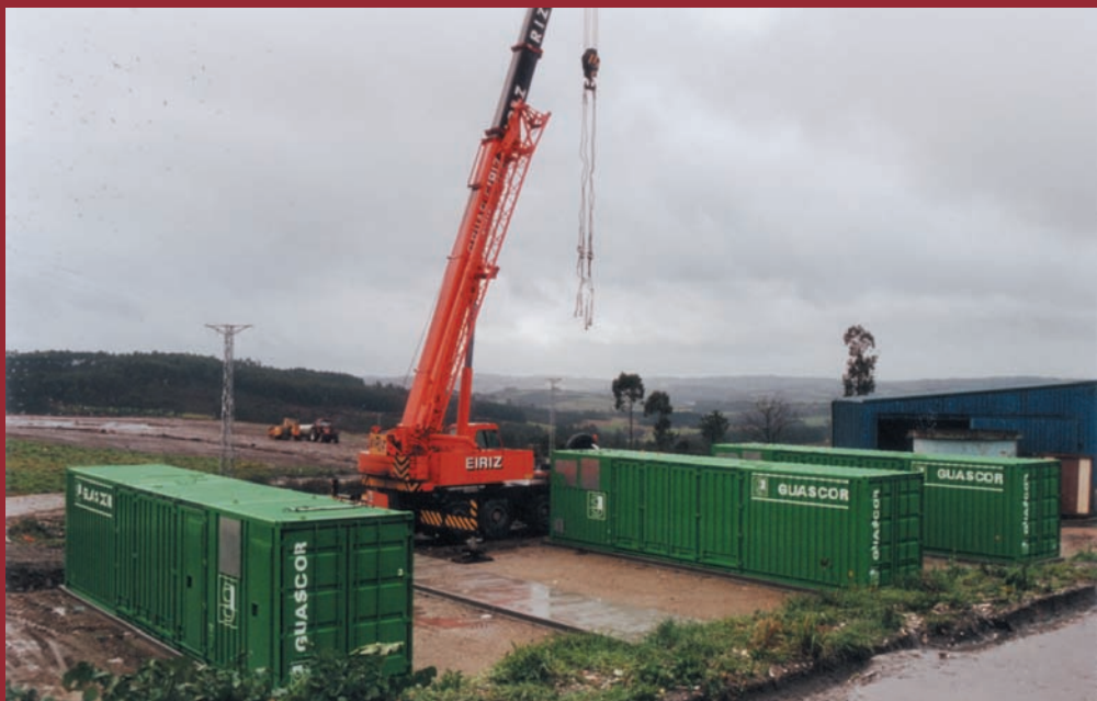
Módulos cabinados Guascor Power.
